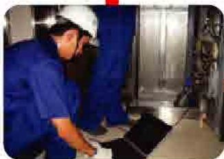
Kiểm tra hệ thống điều khiển và điều chỉnh các tham số nếu cần
