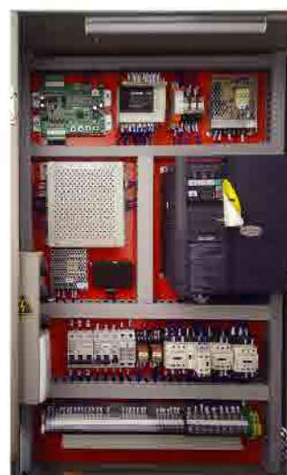
Tủ điều khiển PLC ĐB
